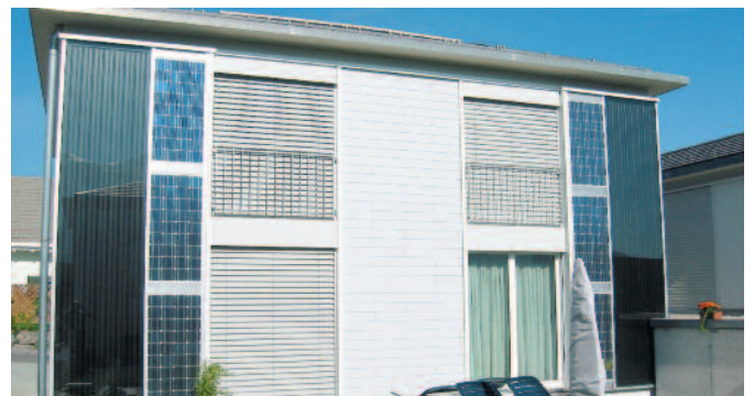
Solaranlage an Fassade
