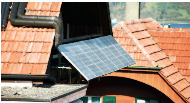
Solaranlage an Fassade
